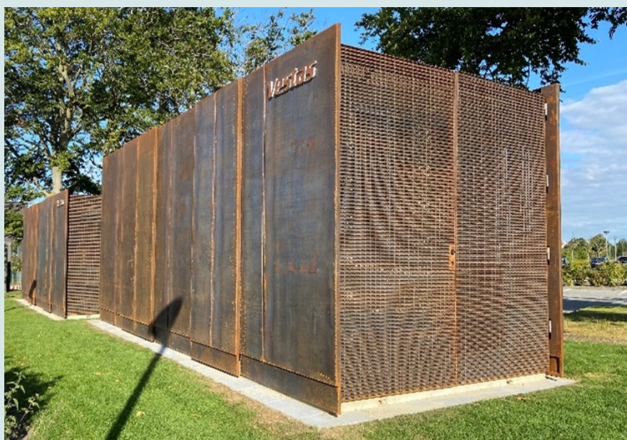
Figur 11: Vestas' egenudviklede batterilager, der kan lagre 2 MWh el og op- og aflade med 2 MW foran Vestas' hovedkvarter på Hedeager 42 i Aarhus.
