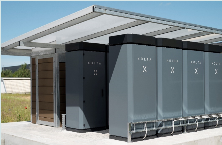
Figur 12: Haarups maskinfabrik ved Silkeborg har monteret 12 XOLTA-batterier, der lagrer el fra fabrikens solceller og gør fabrikken selvforsynende med elektricitet fra marts til november [22].
